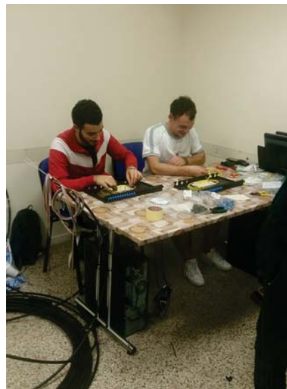
Cablaggio Telai di Terminazione
